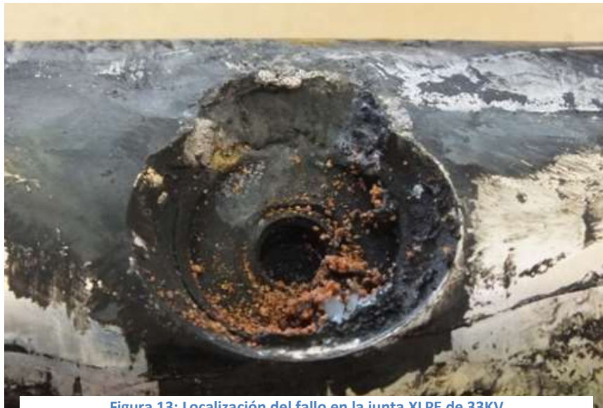
Figura 13: Localización del fallo en la junta XLPE de 33KV
