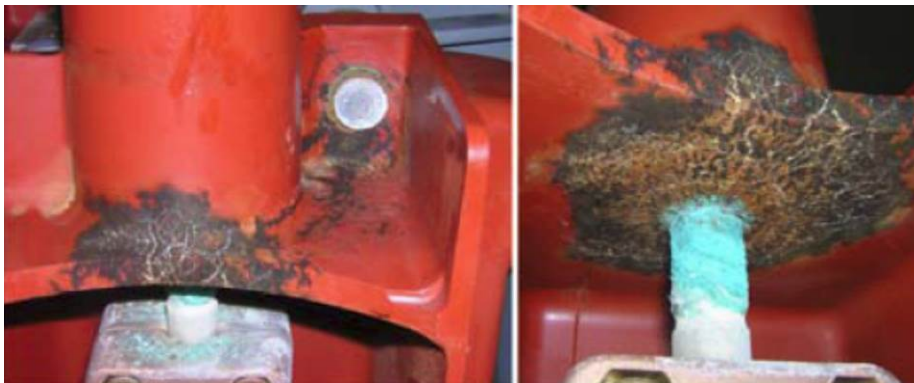
Efectos de la corrosión sobre un interruptor automático, 26 meses después de la contaminación con humedad. Los daños por descarga parcial superficial llevan indefectiblemente a la falla.
